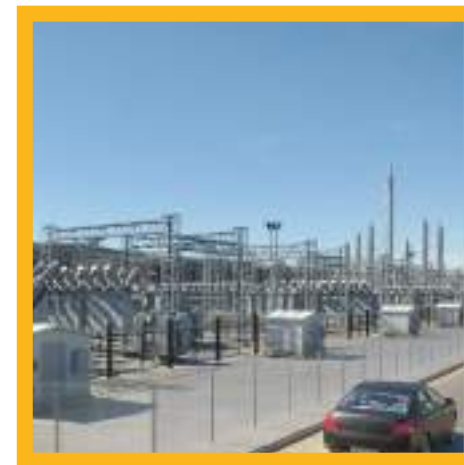
专用电网变电站
